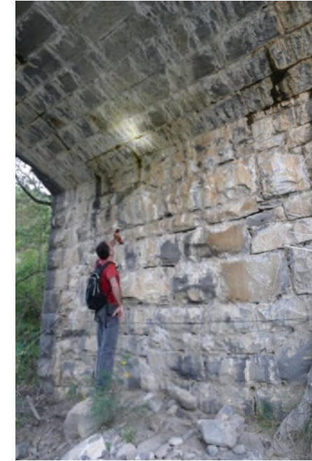
Figura 4.41. Revisión del puente que se prevé demoler, situado en el pk 5,700. Apenas se aprecian grietas aptas para murciélagos, por L. Lorente.
