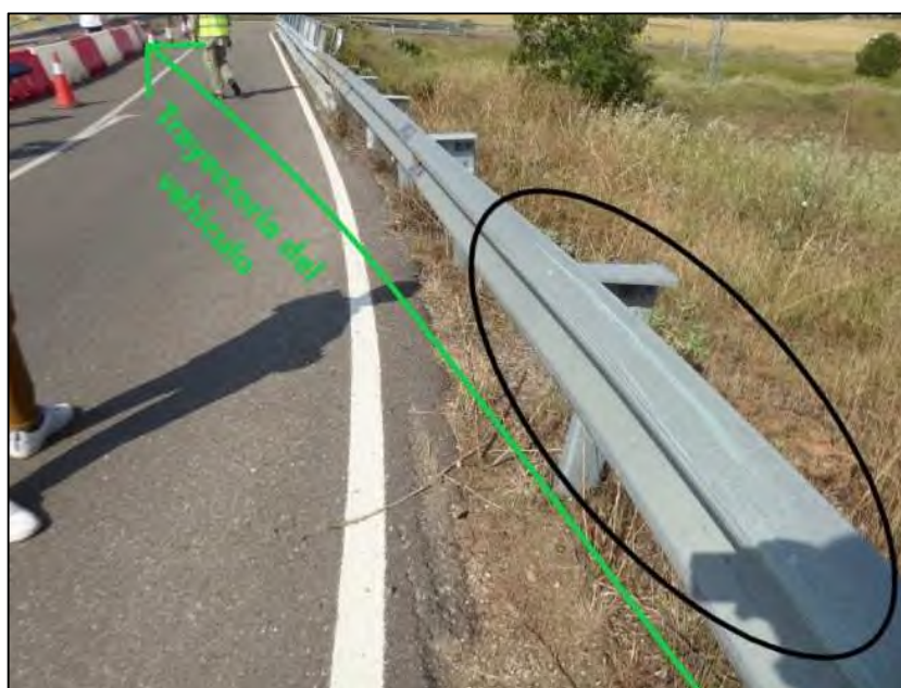
Imagen 24 Detalle de la transferencia de pintura del todoterreno a la barrera de contención
