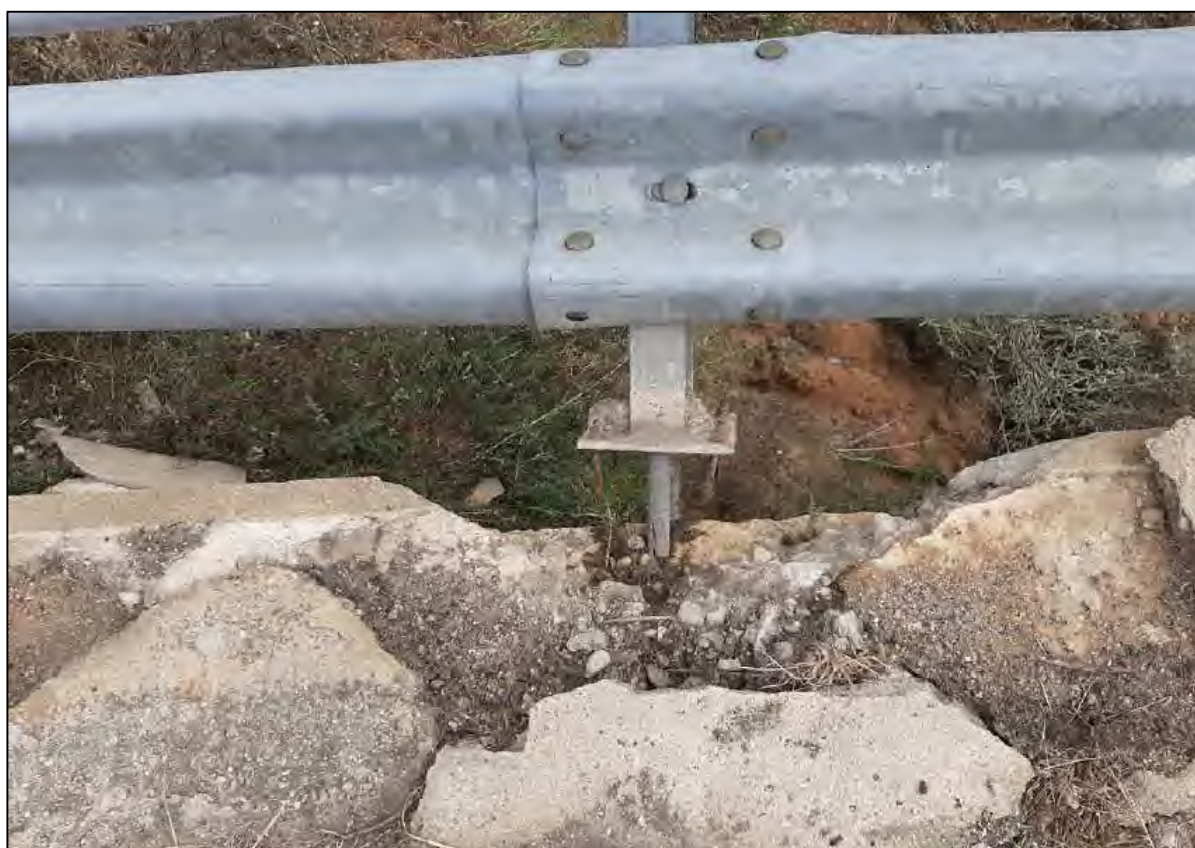
Imagen 32 Detalle de uno de los elementos de cimentación del SCV tras el accidente. Se aprecia la solución adoptada, la falta de armadura y el estado del hormigón.
