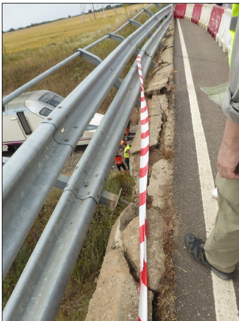
Imagen 31 Se aprecia el fallo de la cimentación del SCV sobre el tablero.
