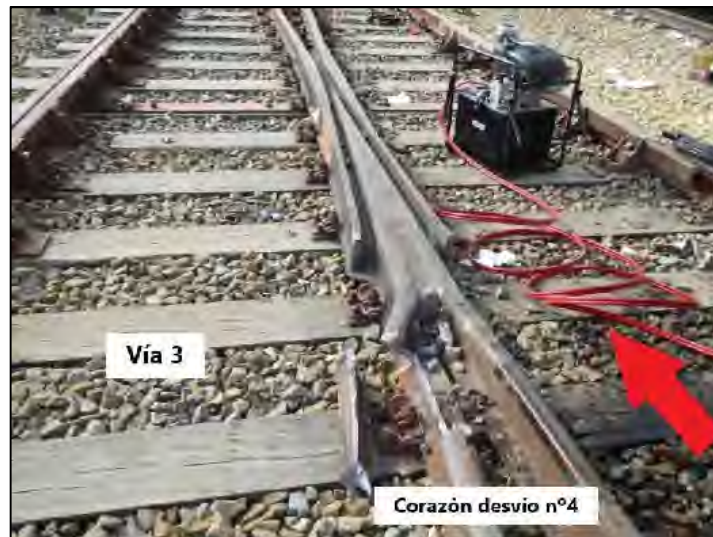
Imagen 15 Daños en el corazón del desvío nº4
