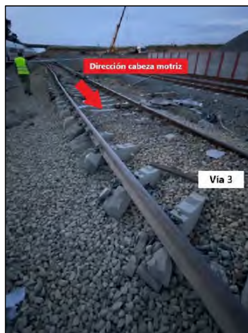
Imagen 16 Daños en vía 3 ocasionados por el giro de la cabeza motriz
