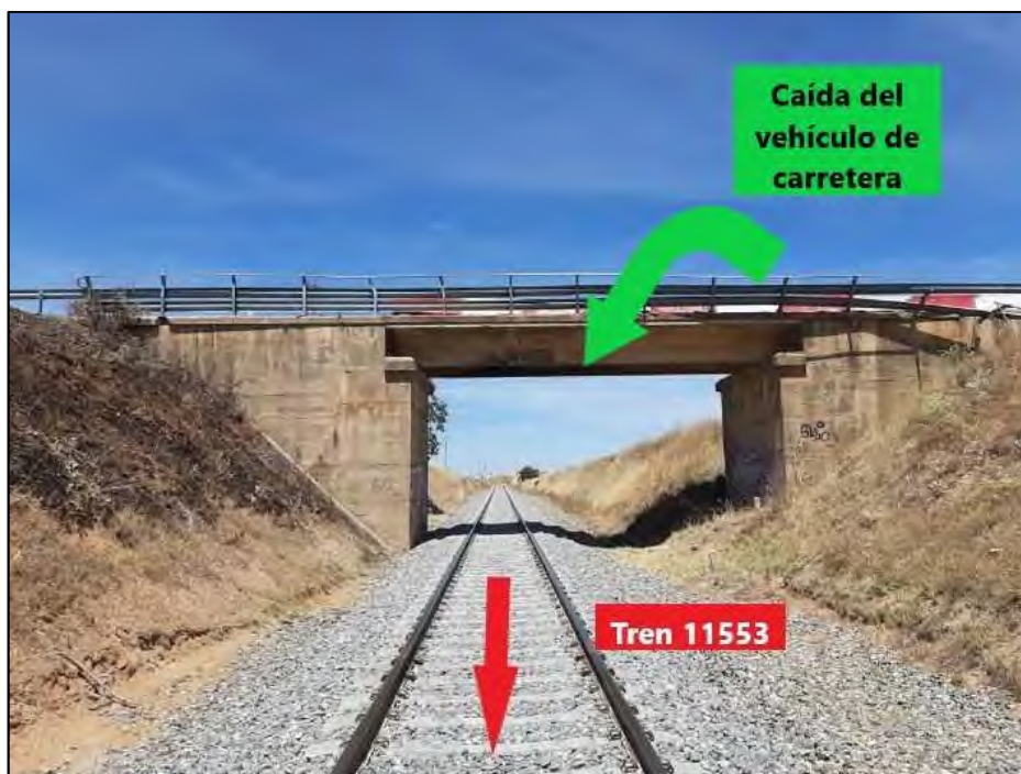
Imagen 10 Vista del paso superior desde el lado Zamora. Se aprecian los daños en el SCV por la caída del vehículo
