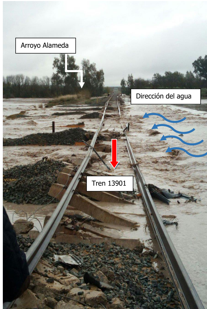
Estado de la vía en el punto "cero" del descarrilamiento. Trayecto que recorrió el tren descarrilado. Fuente Adif.
