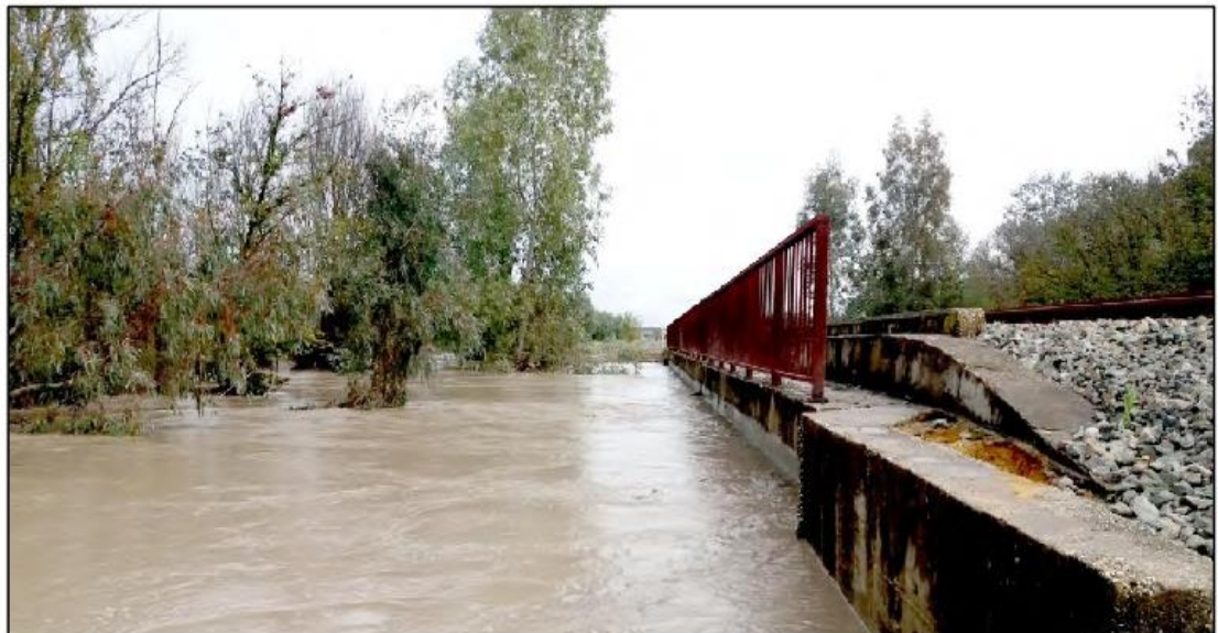
Puente sobre el arroyo Alameda. Imagen tomada 2 horas después del descarrilamiento. Fuente Adif.
