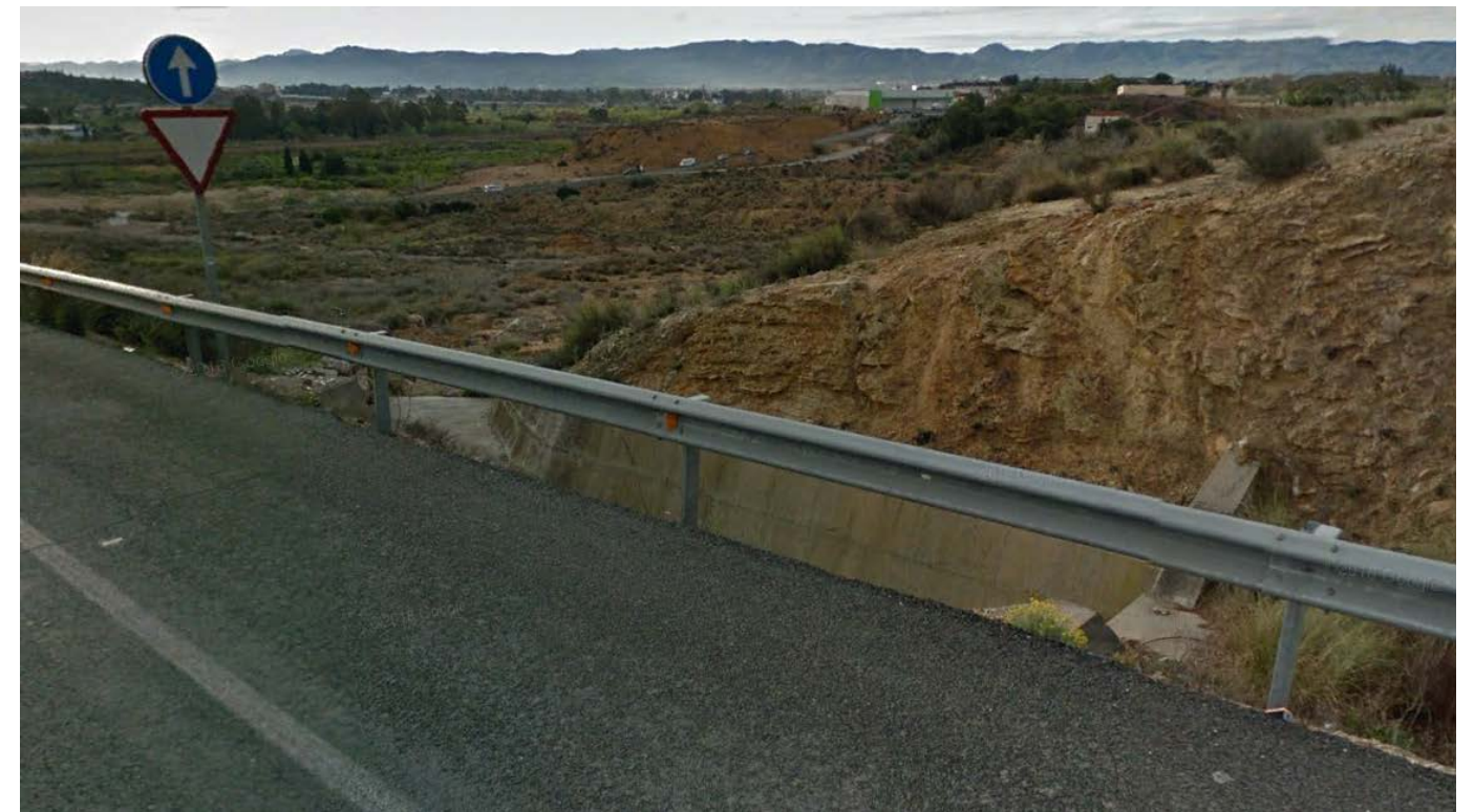
Foto 4: Canal recogida de aguas
