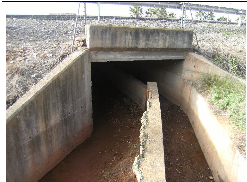
Foto 5. Marco de 3,00 x 2,00 ubicado en las proximidades del P.K.973+480 de la N-340.
