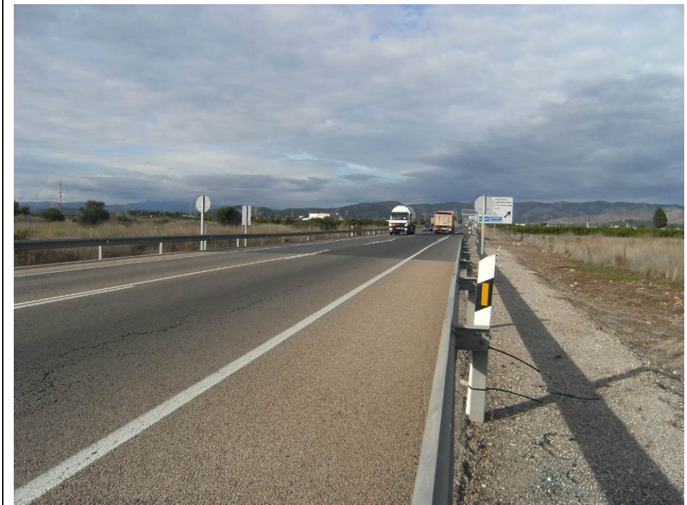
Foto 2. Vista General N-340 sentido ascendente donde se observan el cambio de rodadura.
