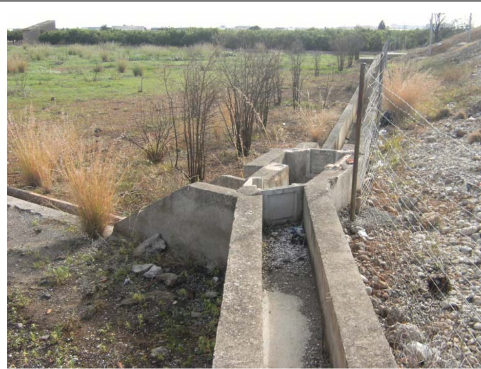
Foto 10. Afección a la red de riego.
