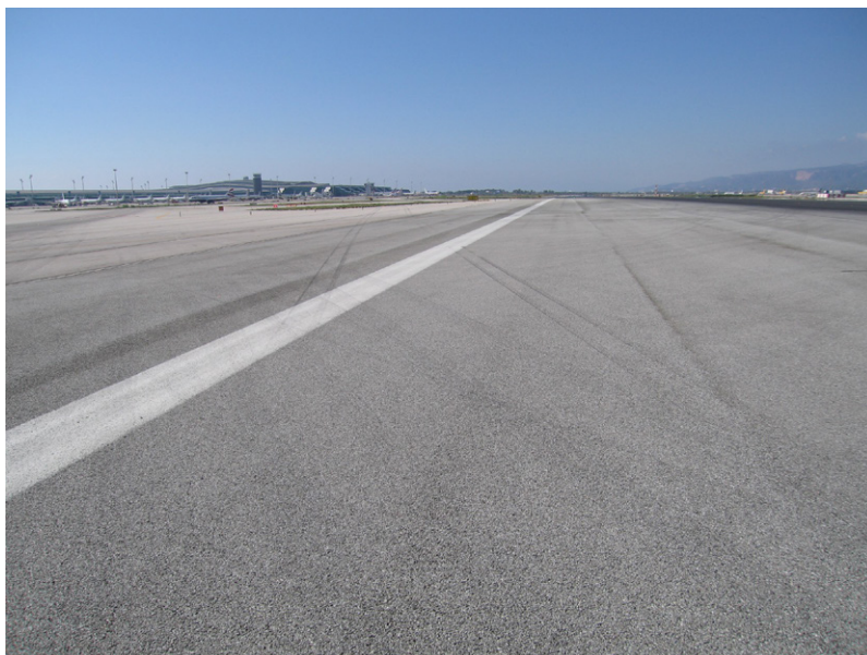
Fotografía 11: Vista de las huellas del tren dejadas en la pista en el sentido de la trayectoria de la aeronave.
