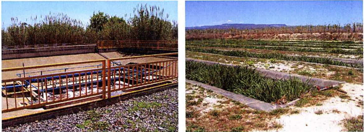
Ilustración 2.24.- Depuradora biológica y canales de macrofitas
