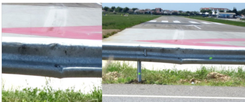
Figura 4. Detalle impacto en guarda rail y huella de arrastre de aeronave
