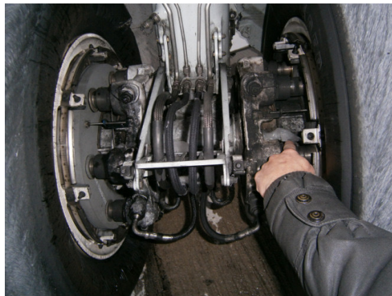
Fotografía 3. Restos de hielo desprendidos y todavía adheridos de los paquetes de frenos
