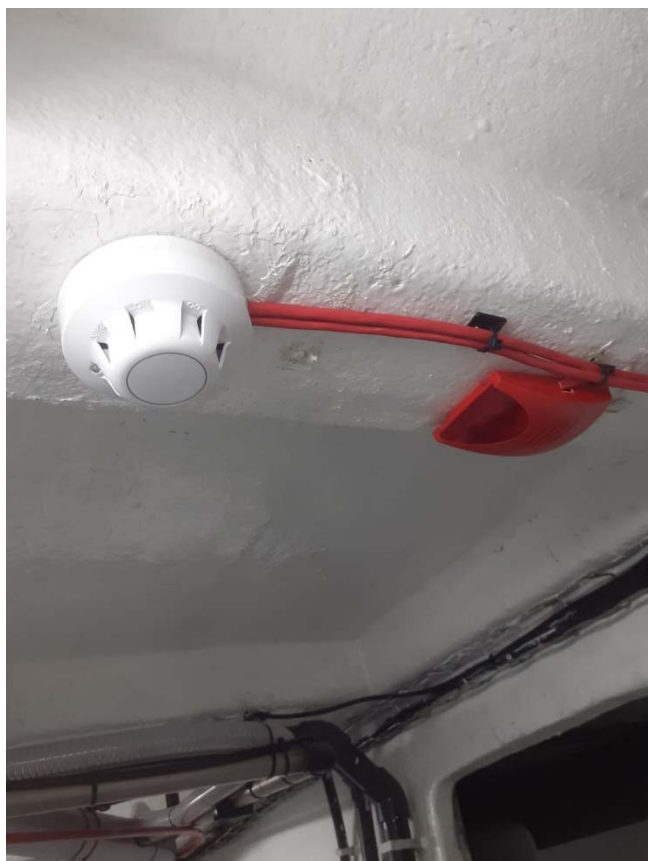
Figura 6. Sistema de detección de incendios de cámara de máquinas
