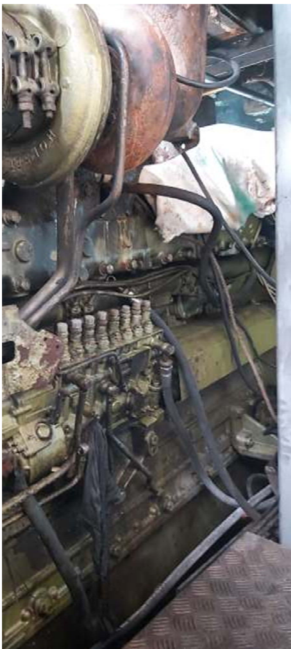
Figura 5. Zona de la cámara de máquinas donde se aplicó el aerosol
