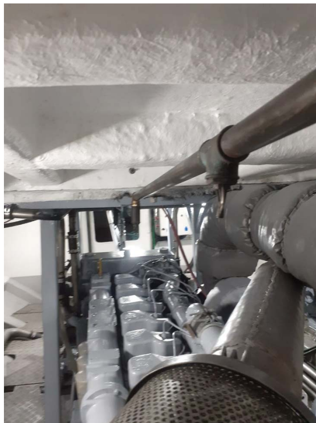
Figura 7. Sistema de extinción de incendios de la cámara de máquinas.
