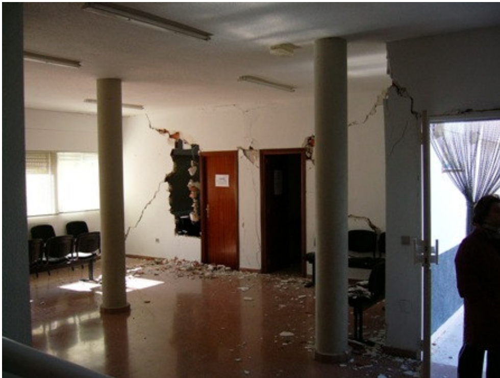
Vista desde el interior con tabiquería dañada por haber entrado en carga
