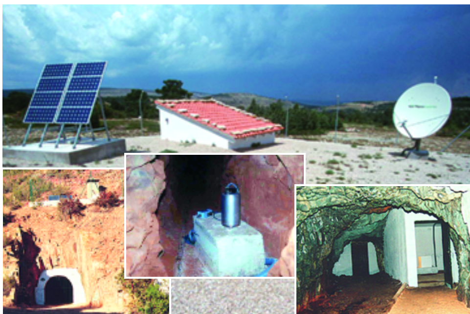
Detalle de instalaciones en dos estaciones sísmicas vía satélite.
