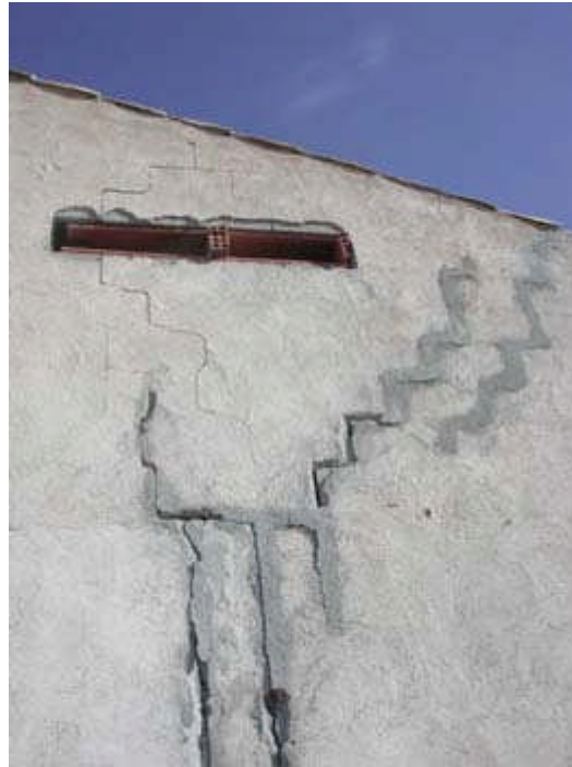
La Paca - Término Municipal de Lorca (Murcia) Reapertura grietas reparadas tras el sismo de 2002
