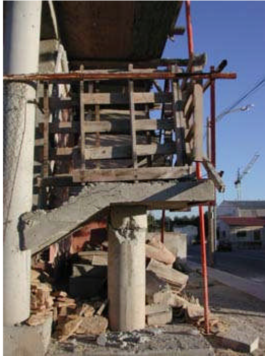
Zarcilla de Ramos- Término Municipal de Lorca (Murcia) Daños en estructura en construcción
