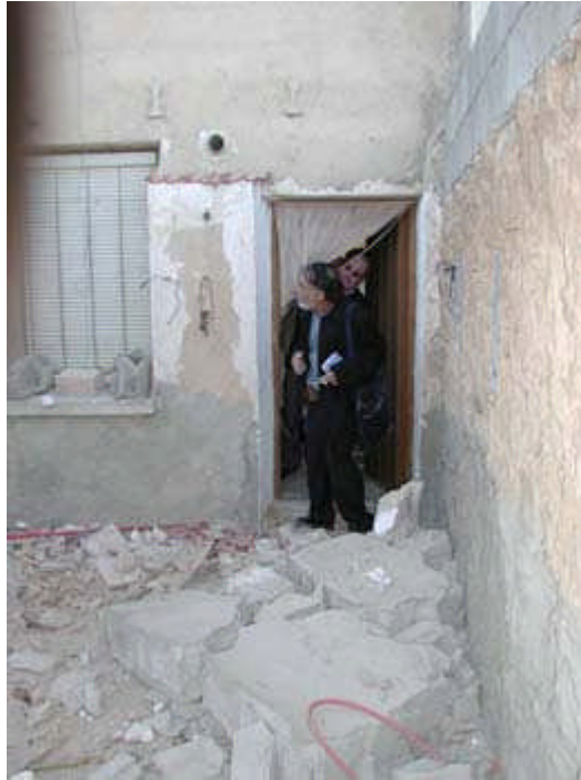
Zarcilla de Ramos- Término Municipal de Lorca (Murcia) Caída voladizos
