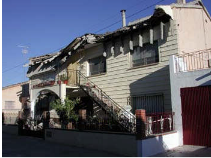
Zarcilla de Ramos- Término Municipal de Lorca (Murcia) Caída voladizos
