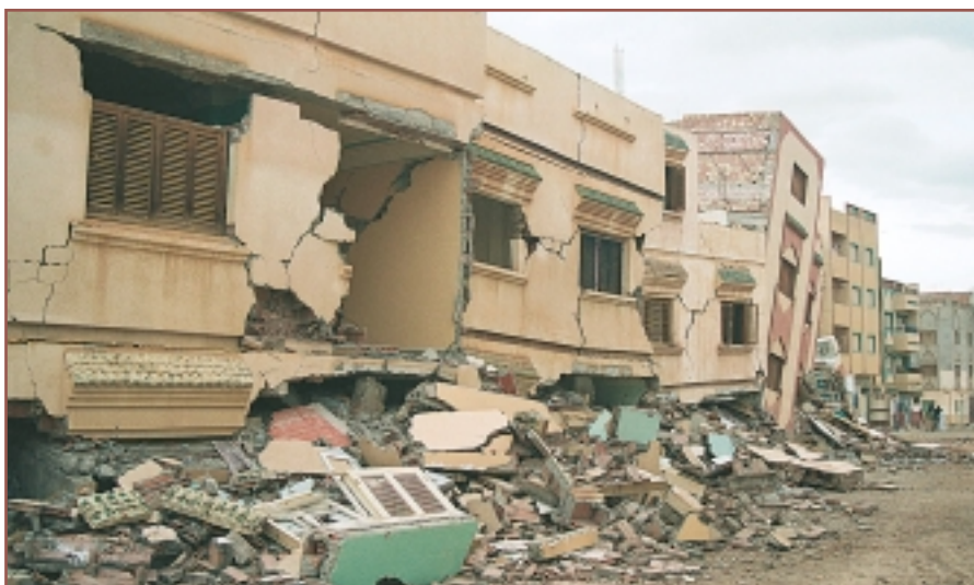
En ambas imágenes puede observarse el derrumbe de las plantas inferiores producido por el terremoto en la localidad de Imzouren.
