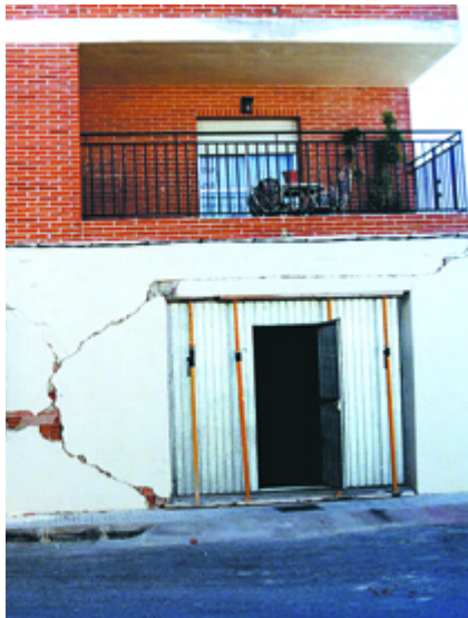
Detalle de daños provocados en Campos del Río por el terremoto del 2 de febrero de 1999.
