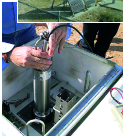
Instalación de uno de los sensores en una de las estaciones.
