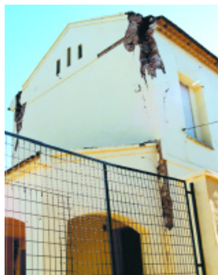
Detalle de los daños provocados en Mula (Murcia) por el terremoto del 2 de febrero de 1999.
