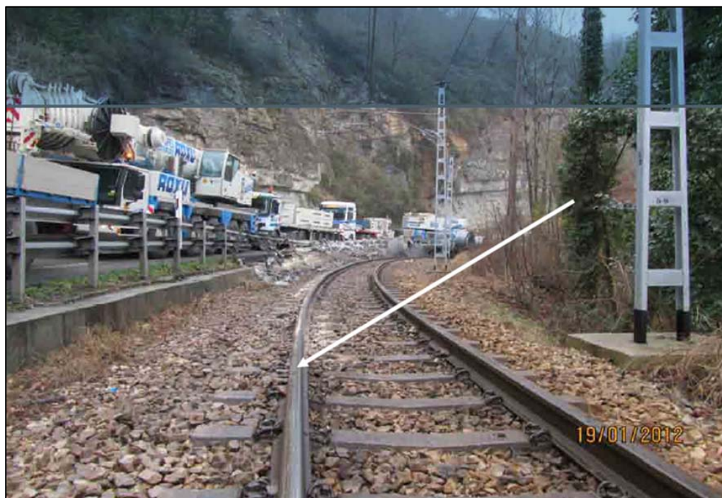
Punto del descarrilamiento (PK 378+049) (Fuente Feve)
