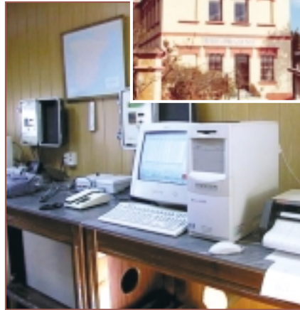
Sala de registro magnético.
